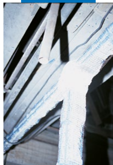
Estructura de concreto deteriorado
