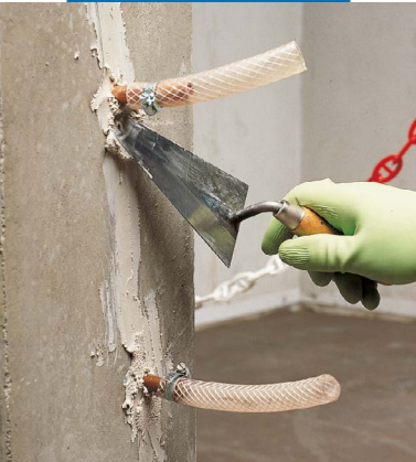
Fijación de tubos de inyección y estucado de las fisuras en consolidación estructural
